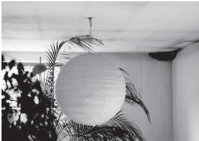
Abb 4: Schimmel in der oberen Wohnzimmerecke bei raumfüllender Bepflanzung des Wohnzimmers
