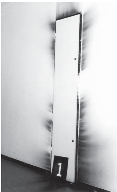
Rauchfahnen im Bereich einer Steigleitung (Brandursache: Kellerbrandstiftung)
