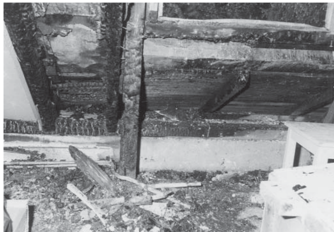
Brandentstehungsbereich im Dachgeschoss (Brandursache: Heißarbeiten – Hartlöten)
