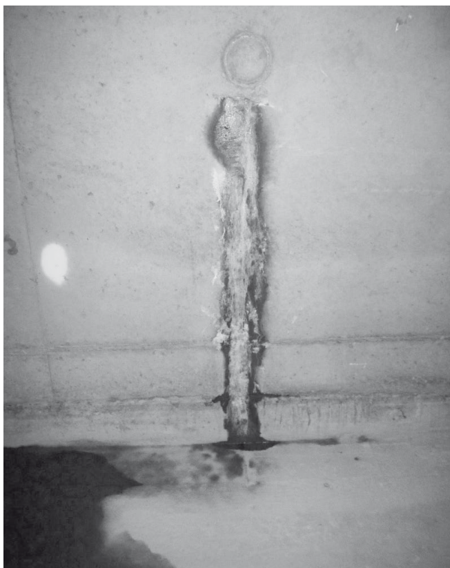
Abbildung 2: Selbstheilung eines Risses – Bildung von Kalziumkarbonat
