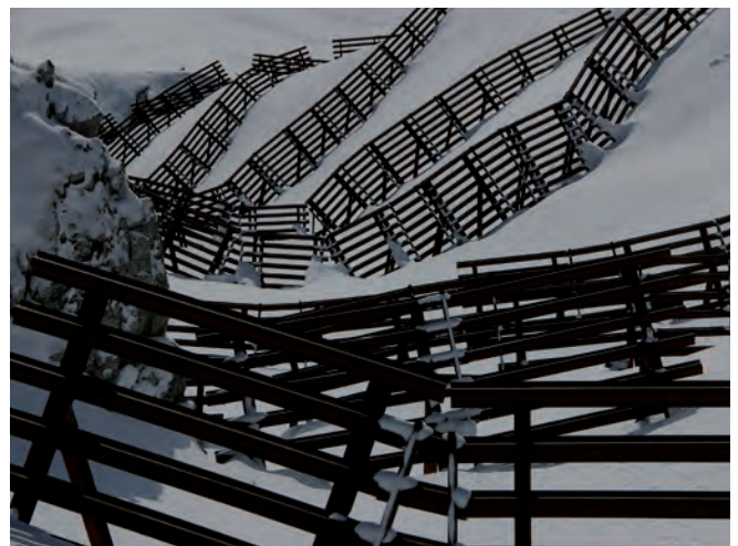
Abbildung 2: Lawinenverbauung im Anbruchgebiet mit Stahlschneebrücken (Foto Sauermoser)
