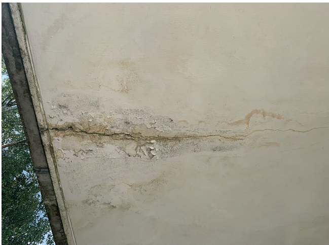
Abbildung 3: Riss und Durchfeuchtung der Balkonplatte
