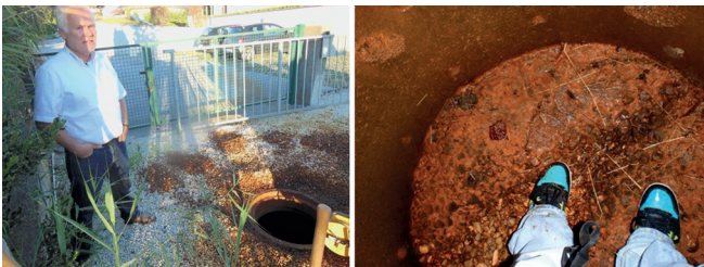
Abbildung 3: Ausfällungen von Eisenhydroxid (Limonit) bei einem Sickerschacht, welcher verschlammte ist
